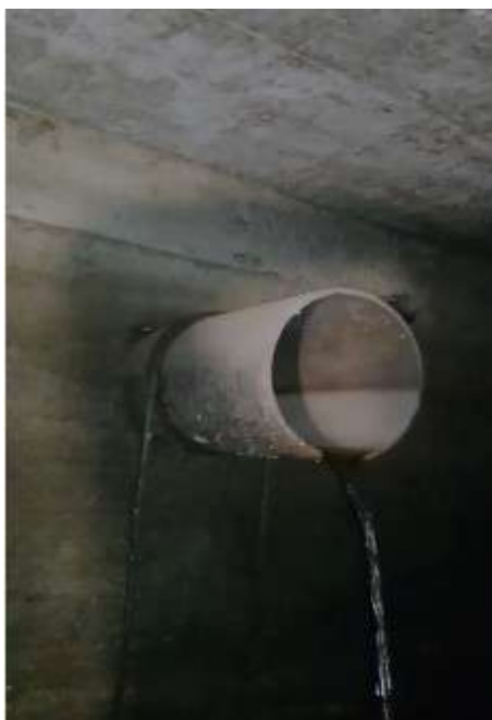
Figura 2 – Tubulação com fluxo contínuo de água
