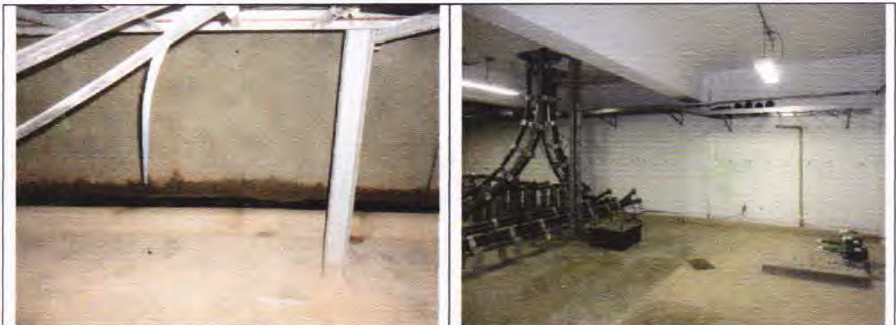
Figura 5.1 – Detalhes das canaletas de condução das águas subterrâneas captadas.
