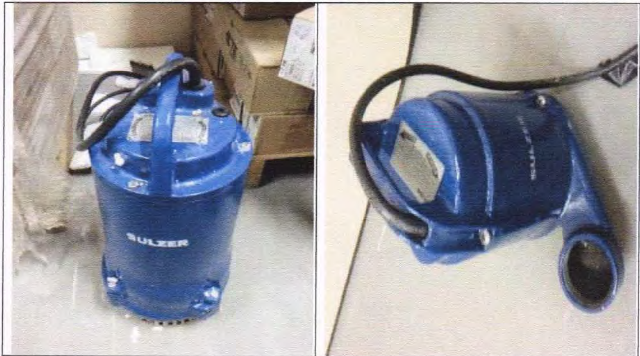
Figura 5.3 – Bombas instaladas no poço de drenagem (esquerda) e fosso do elevador (direita).
