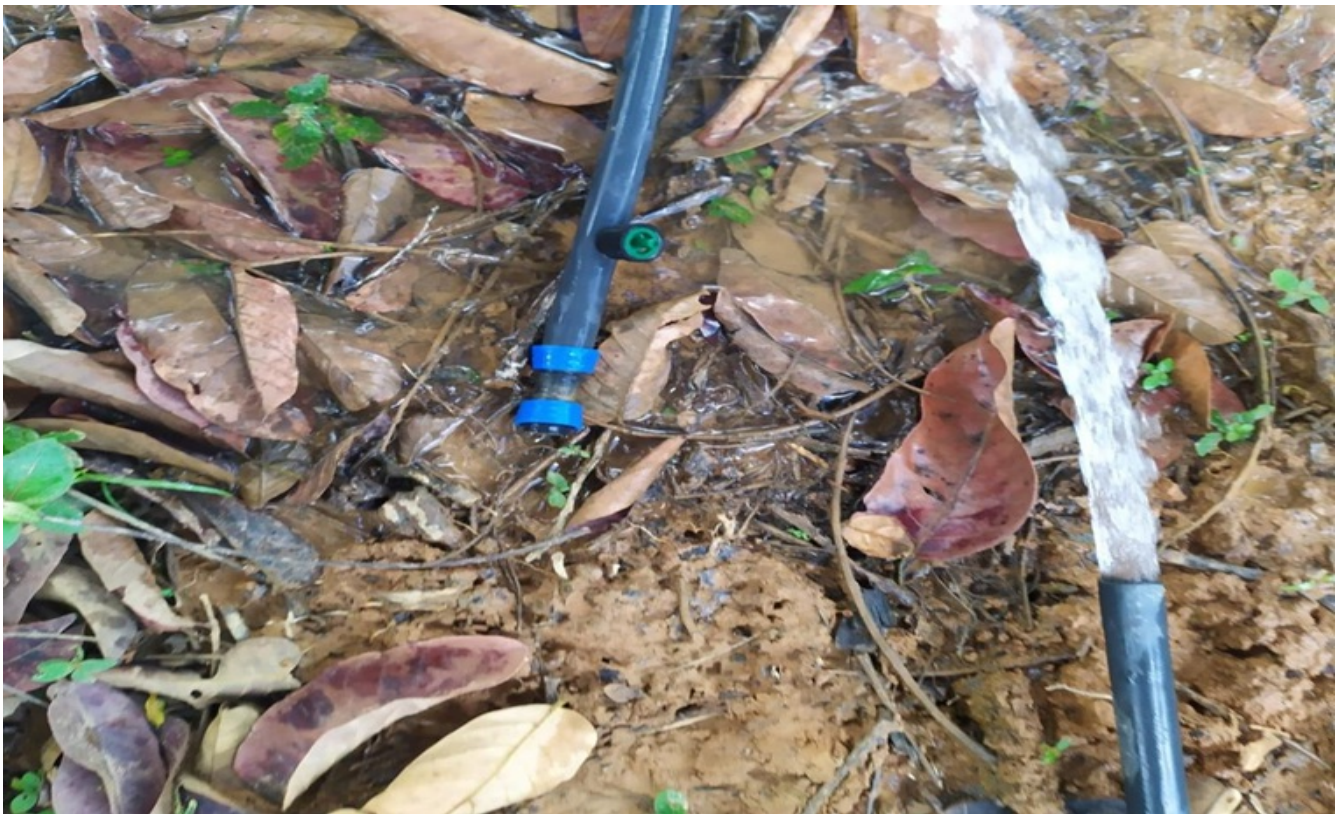
Figura 6: Tubulação estourada, necessitando reparo.
