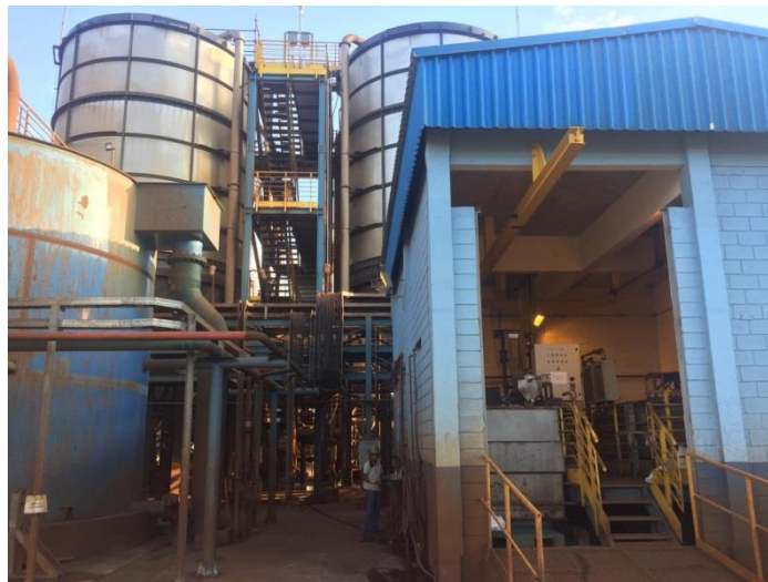
Foto 2: Processo de filtração de rejeito em operação. O material gerado da filtração será direcionado para a área de empilhamento sobre os drenos de fundo do Fraile.
