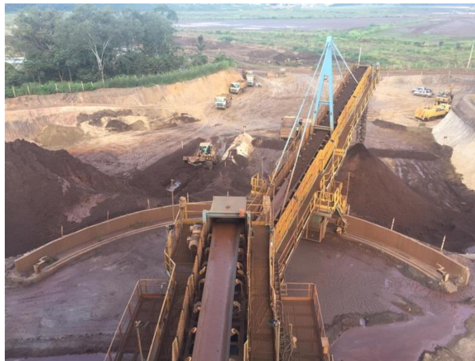
Foto 4: Processo de filtração de rejeito em operação. O material gerado da filtração será direcionado para a área de empilhamento sobre os drenos de fundo do Fraile.
