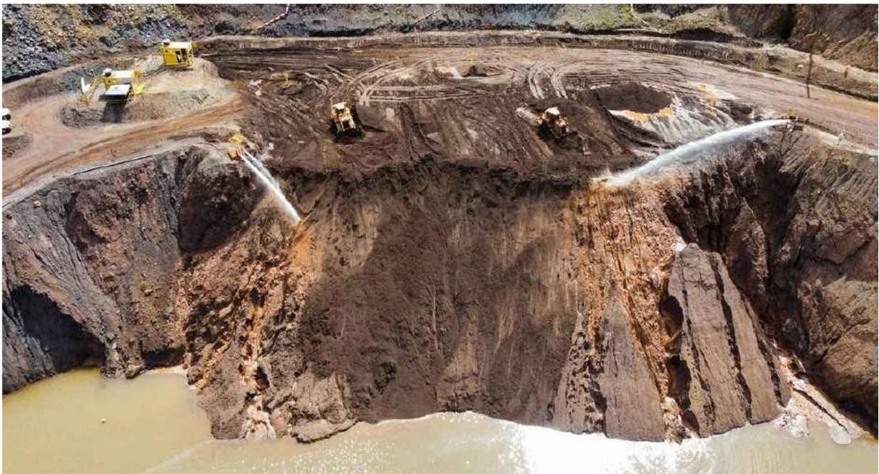
Figura 2: Cava Mina Córrego do Feijão – Desmonte de Rejeito Agregado ao Talude – Vista Frontal. Fonte: Relatório Técnico FCS Consultoria (Vale, 2022)
