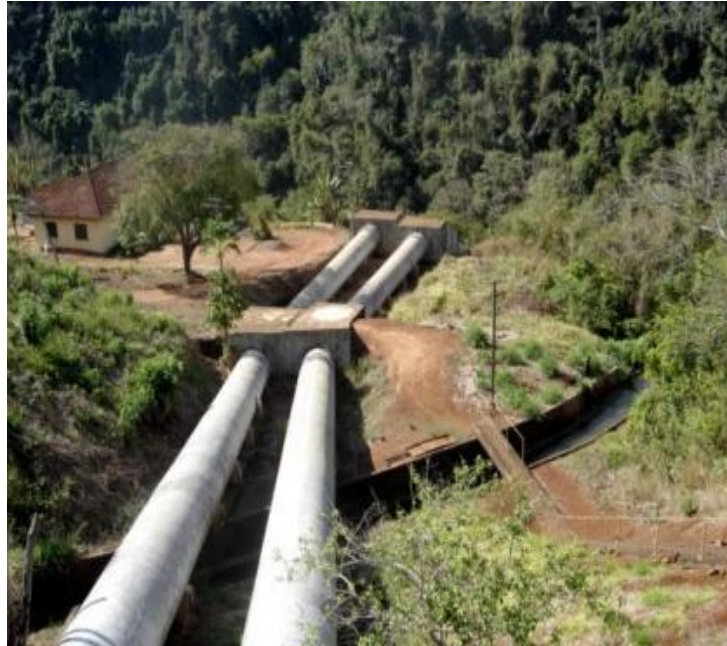
Figura 3: Vista dos Conduitos Forçados.
