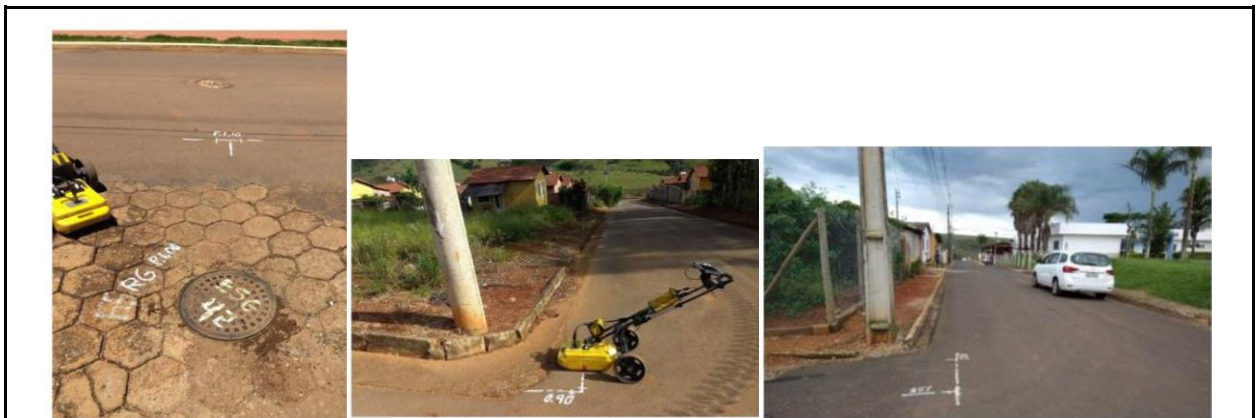
Registro da localização de rede e PV, marcação em piso, GRP (GeoRadar) e marcação no piso e na via no município de Indianópolis.
