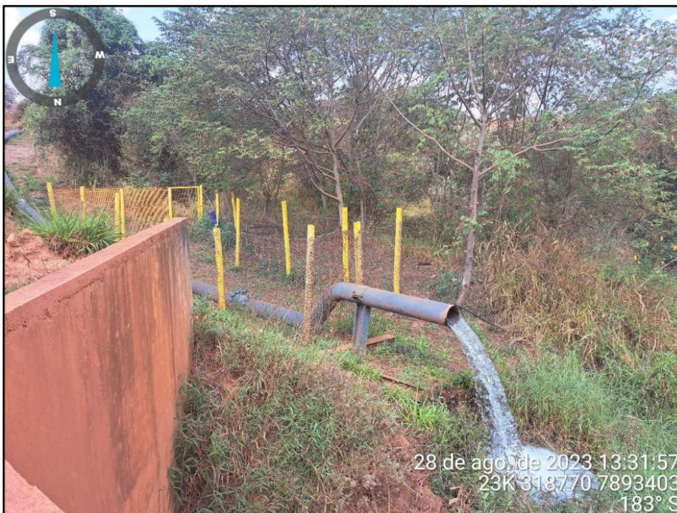
Figura 17. Estrutura de restituição de vazão residual do Córrego do Sabão.
