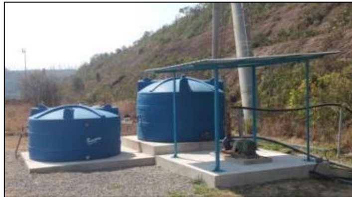
Figura 2.7.11.1: Melhorias na estação de água para o processo
