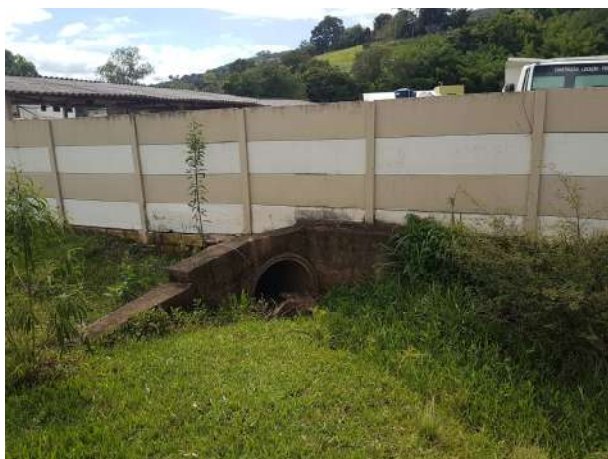
Figura 3 – BSTC Ø 1,00 m pleiteado encontrado no Loteamento Maranhá, a jusante do Loteamento Alfa, que pleiteia a outorga de prolongamento de canalização.
