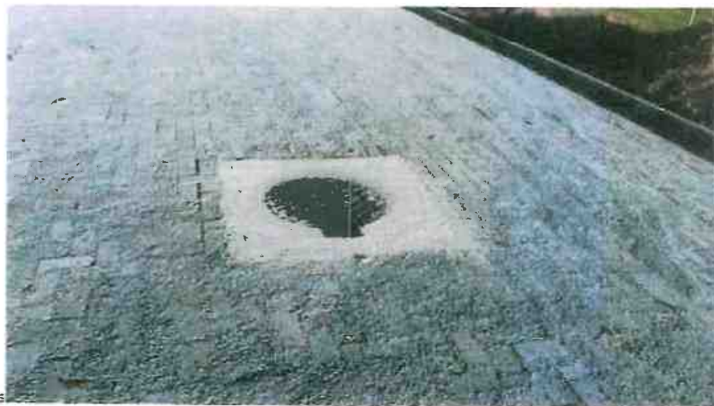
FOTO 02: SISTEMA DE DRENAGEM PLUVIAL
