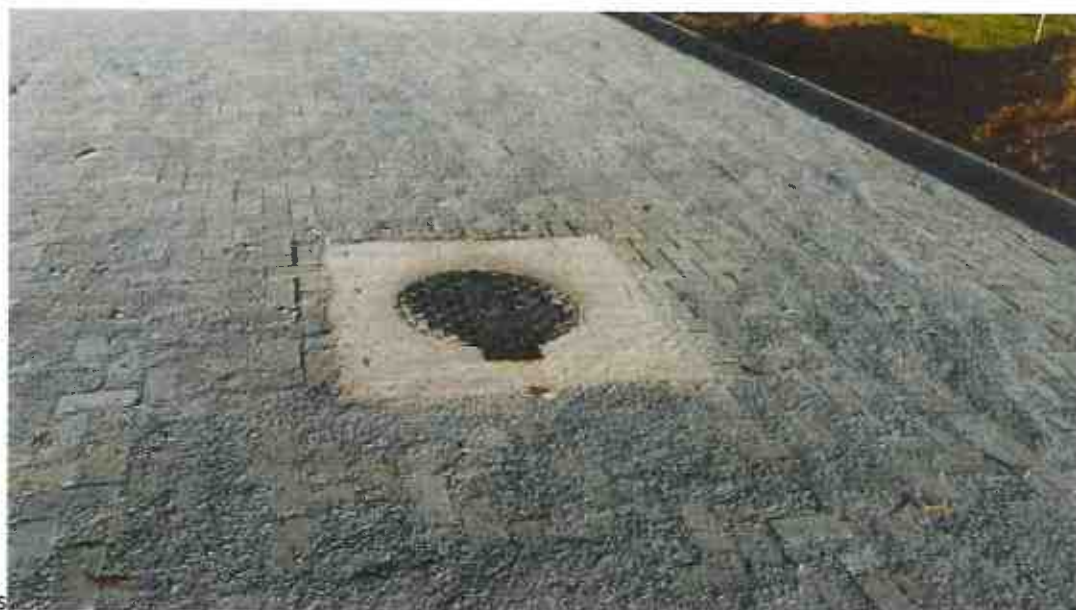
FOTO 02: SISTEMA DE DRENAGEM PLUVIAL
