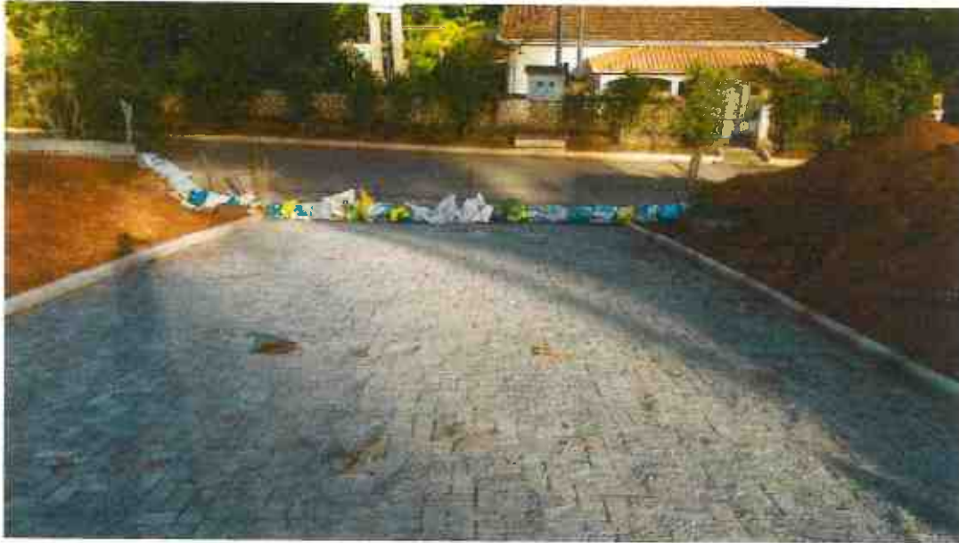
FOTO 01: SISTEMA DE CONTENÇÃO "RIP RAP"
