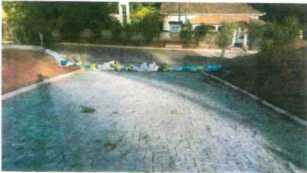
FOTO 01: SISTEMA DE CONTENÇÃO "RIP RAP"
