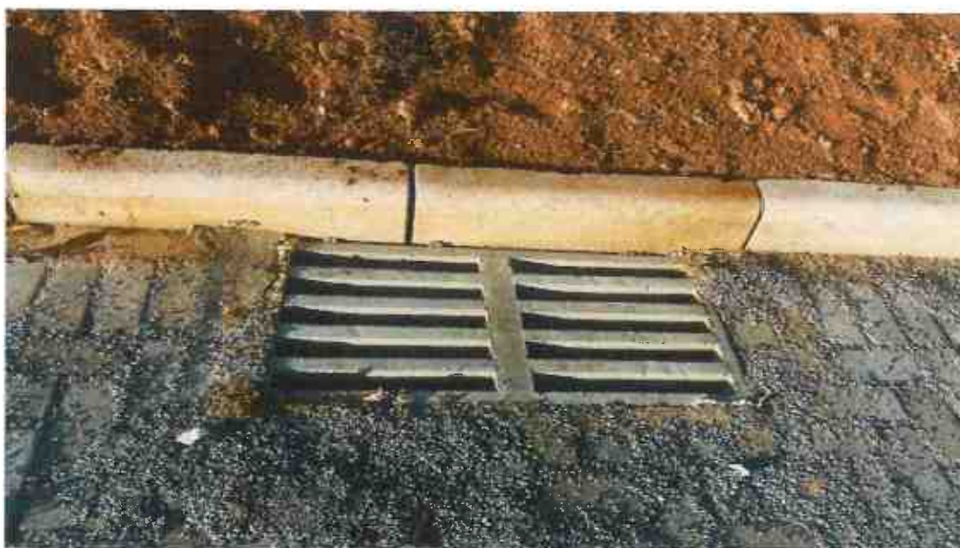
FOTO 04: COMPONENTE DO SISTEMA DE DRENAGEM PLUVIAL
