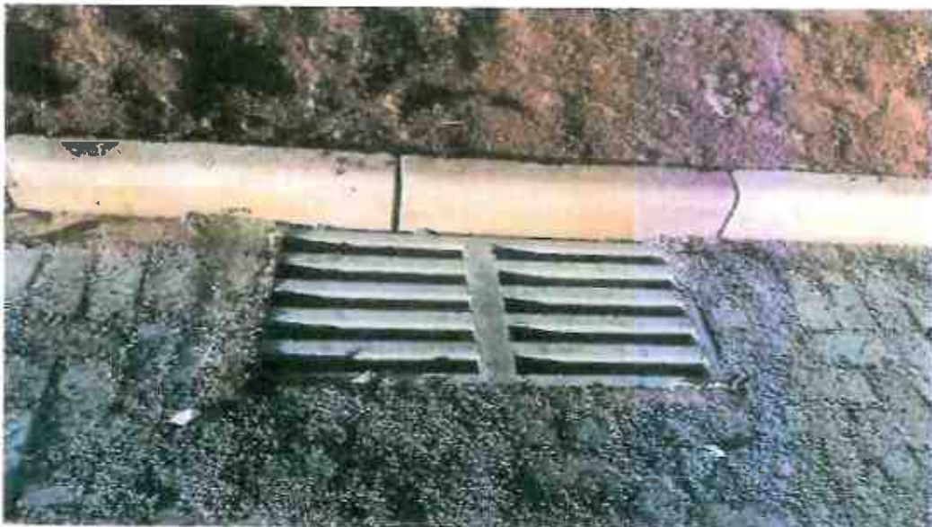
FOTO 04: COMPONENTE DO SISTEMA DE DRENAGEM PLUVIAL
