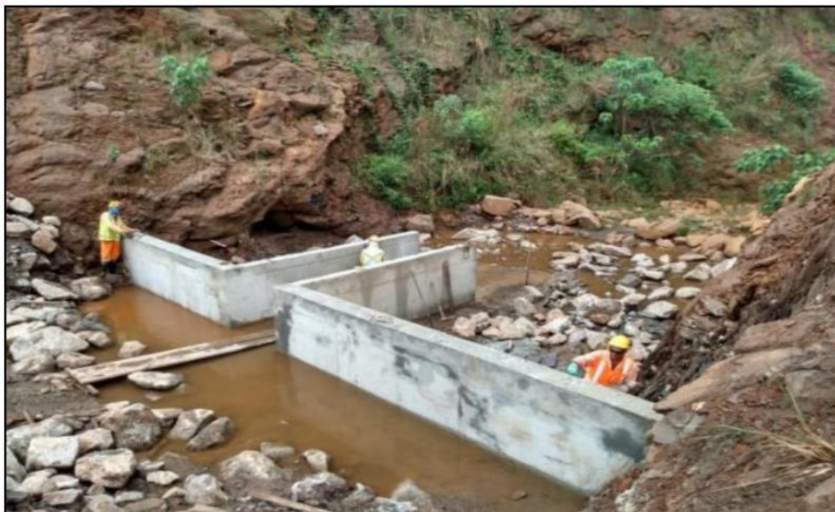
Figura 9. Ponto de monitoramento de vazão e de qualidade a jusante da PDER Eixo 1
