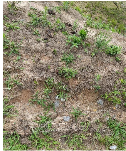
Foto 10: Ponto ITS03: Propriedade B11. Biomanta danificada. Necessidade de manutenção.
