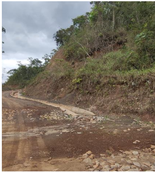
Foto 2 - a: Trecho 3: Entorno da estrutura de drenagem. Necessidade de manutenção e recobrimento vegetal dos taludes.
