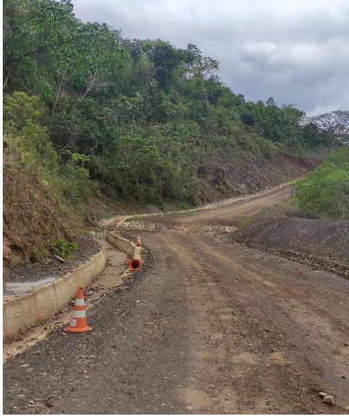
Foto 3: Trecho 3: Margens da Estrada. Necessidade de manutenção.
