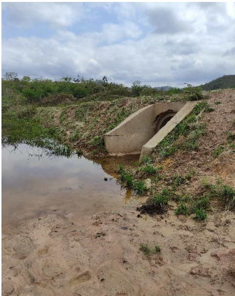
Foto 9: Ponto ITS03: Propriedade B11. Sistema de drenagem (implantação de bueiro e canaleta) com reconformação de talude.
