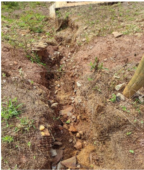
Foto 13: Ponto ITS05: Propriedade B11. Intenso processo erosivo na proximidade do bueiro.
