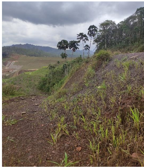
Foto 5: Cãnion 3: Hidrosseadura de taludes. Presença de falhas.
