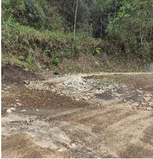
Foto 1 - a: Trecho 3: Sistema de Drenagem ITS01
