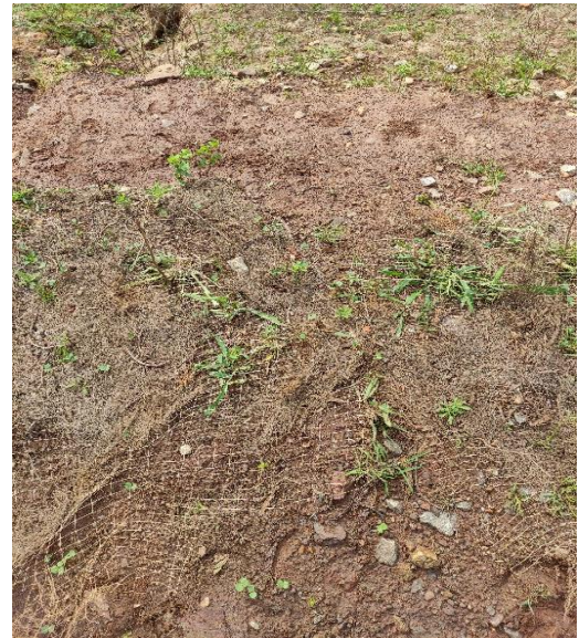
Foto 12: Ponto ITS05: Propriedade B11. Biomanta danificada. Necessidade de manutenção.
