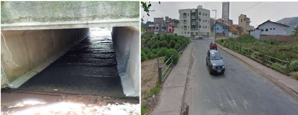
Figura 18: canalização no cruzamento entre rua Antônio de Almeida Marques e rua Maria Grazia Errico (coordenada: 334765.204, 7589933.436, Sigas 2000 23 S).
