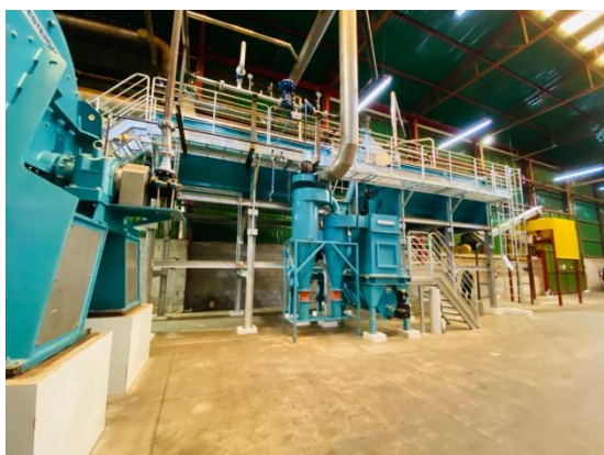
Foto 01. Equipamentos instalados da linha de peixe (ampliação)
