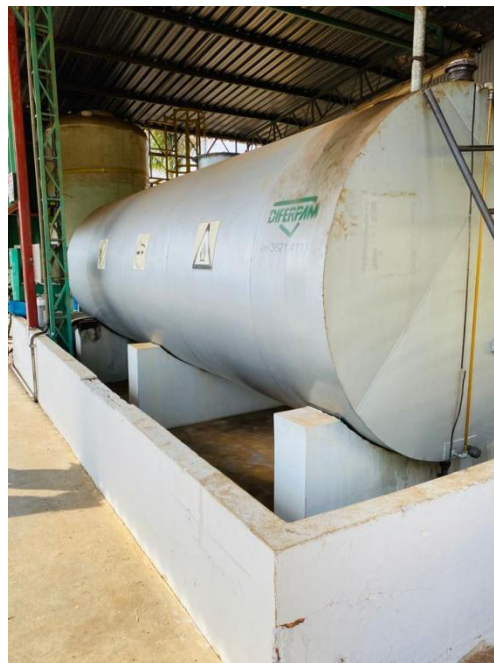
Foto 02. Bacia de contenção do tanque de armazenamento de combustíveis
