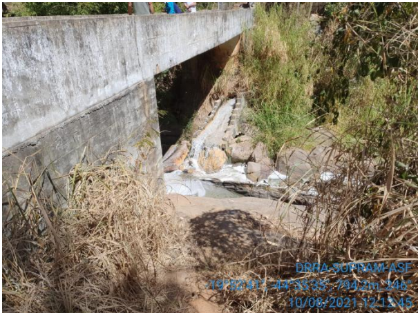
Foto 5 - Ponto de lançamento de efluentes tratados
