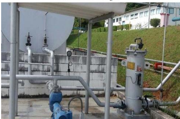
Foto 3: Dutos de descarga e abastecimento
