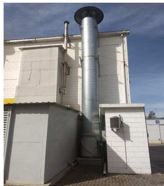
Foto 12: Chaminé cabine de pintura
