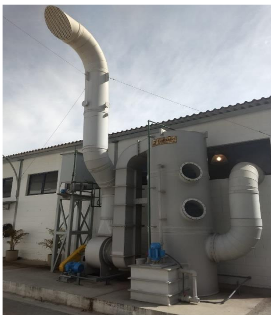
Foto 11: Lavador de gás – Tratamento de superfície
