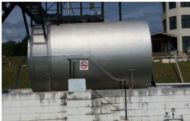
Foto 2: Tanque de armazenamento.
