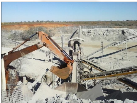
Foto 17: Área de britagem
