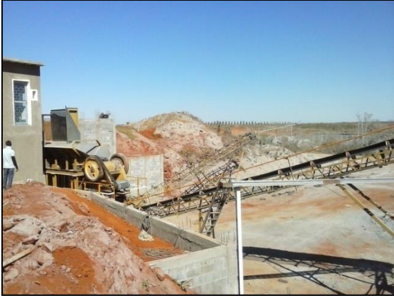
Foto 19: Área de britagem
