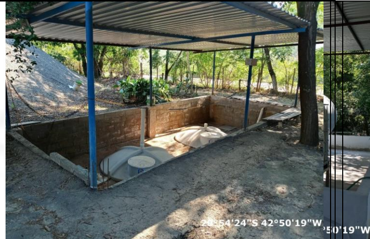
Foto 12: Vista do Sistema de Fossa/Filto dotado de caixa de contenção
