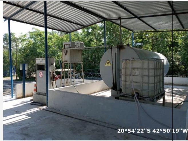
Foto 10: Vista do Posto de Abastecimento dotado de caixa de contenção
