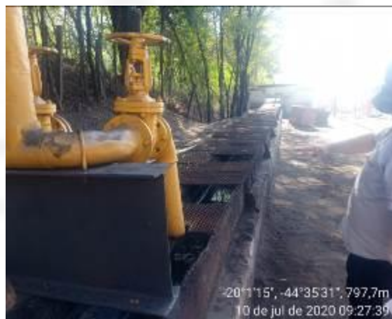
Foto 04. Tratamento efluentes lavador gases
