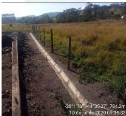
Foto 11. Sistema de drenagem pluvial
