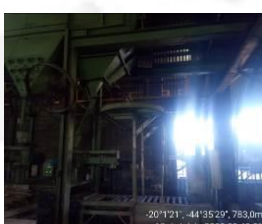
Foto 06. Recuperador de areia.
