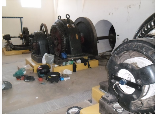
Foto 06. Parte interna da casa de bomba
