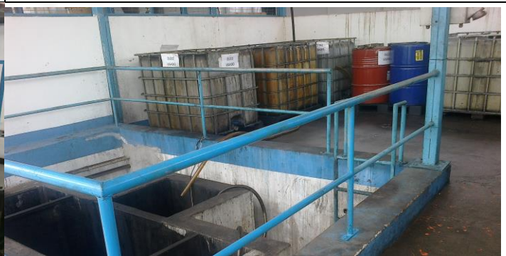
Foto 4: Caixa separadora de água e óleo.
