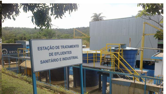
Foto 09: Estação de tratamento de efluentes sanitários e industriais
