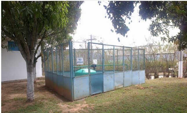
Foto 08: Captação de água em poço artesiano
