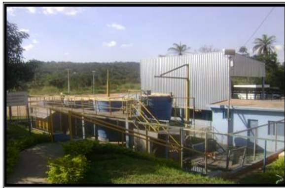
ESTAÇÃO DE TRATAMENTO DE EFUENTES SANITARIOS (BIOLOGICOS)
